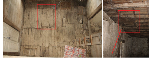
Şekil 48-49. Sofa Mekânı Zeminin Döşemesi, Bodrum Kata İnişi İçin Bırakılan Kapağın Üst ve Alt Döşemeden Görünüşü
